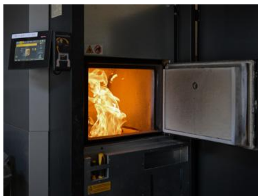
バイオマスボイラー
