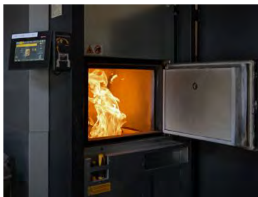
バイオマスボイラー
