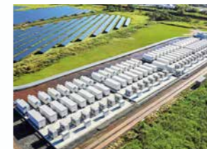
すずらん釧路町太陽光発電所の蓄電池
