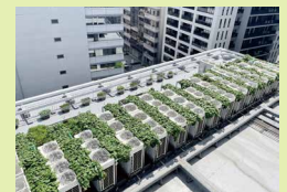
ウノサワ東急ビルの芋緑化システム
