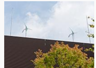
風力発電（東急プラザ表参道原宿）
