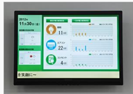
各フロアのエネルギー管理モニター
