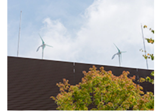
風力発電 (東急プラザ表参道原宿)
