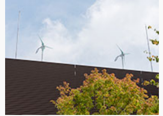
風力発電 (東急プラザ表参道原宿)
