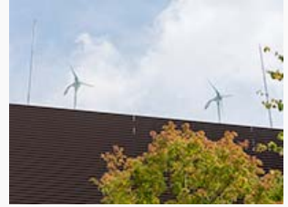
風力発電 (東急プラザ 表参道原宿)
