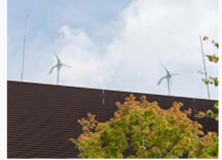
風力発電 (東急プラザ 表参道原宿)
