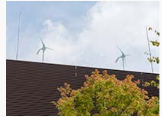
風力発電 (東急プラザ 表参道原宿)
