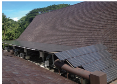
パラオ・パシフィック・リゾートの太陽光発電
