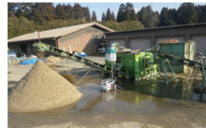
バンカー砂の洗浄システム
