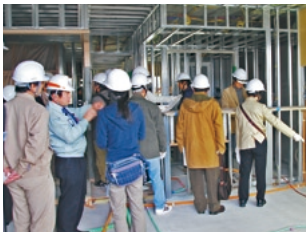
部屋ができていく過程がよくわかると好評な建築現場見学会
