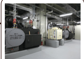
空調の熱源となる冷水・温水の温度差を、これまでより大きく設定。必要な水量を減らすことで、送水ポンプの電力を削減。
