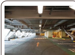
駐車場の換気は、ダクトレス化し、小型ファンを適所に設けることで、フロアごとの空気循環を実施。
