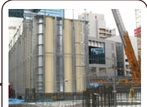
夜間に冷熱を製造し、昼間にその熱を利用する「氷蓄熱システム」を採用。電力のピークシフトや熱源の運転効率が向上。
