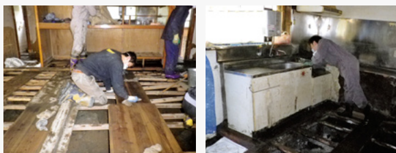
津波の被害を受けたお宅の泥の掻き出し・清掃作業
