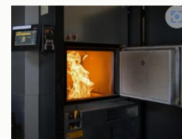
バイオマスボイラー
