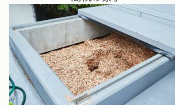
バイオマスボイラー
